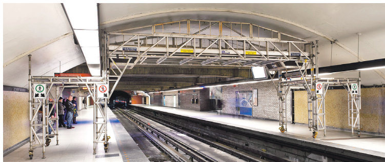
Un exemple d'échafaudage utilisé pour l'entretien de goulottes au niveau des voûtes.
