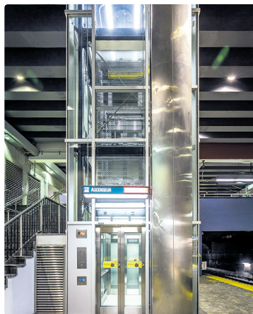
Des travaux d'installation d'ascenseurs sont déjà en cours dans neuf stations. Celui-ci a été inauguré à la station Jean-Talon
