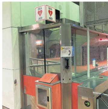
L'installation d'un défibrillateur externe automatisé à proximité de la loge d'une station de métro.
