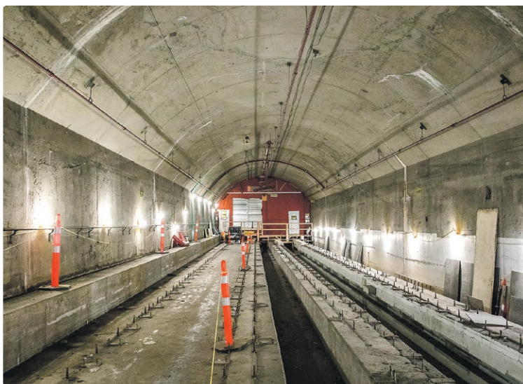
Vue de l'arrière de la cloison où les équipements de voie et de contrôle des trains ainsi que le câblage électrique ont été retirés pour réaliser la jonction.
