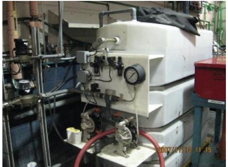
Réservoir du système de recyclage des eaux Atelier GR
