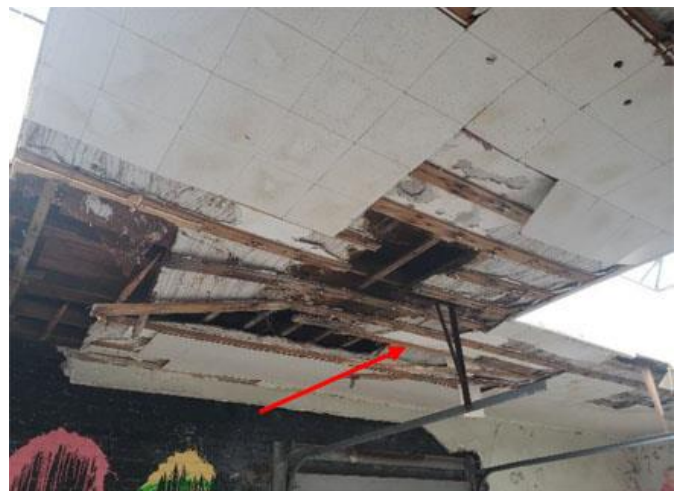
FIGURE 37 Plafond de l'aire ouverte à l'étage qui démontre l'état de dégradation de l'immeuble soumis à des infiltrations d'eau et aux squatteurs. Source : STM.
