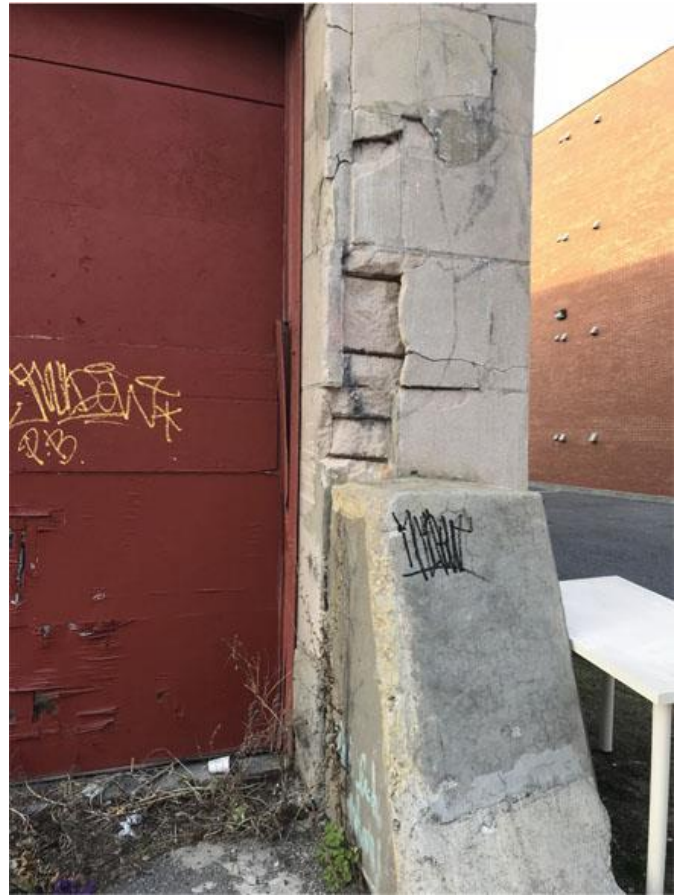
FIGURE 29. La pierre reconstituée en béton moulé est abîmée en façade principale, laissant apparaître son armature en béton. Le massif en béton situé à l'entrée de l'ancien passage servait de chasse-roue. Source : STM.
