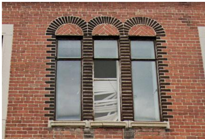
FIGURE 24 Détail de la façade principale montrant les fenêtres au-dessus de l'entrée centrale. Des briques de couleur foncées forment des chaînages autour des fenêtres ainsi que des arcs décoratifs dans la partie supérieure avec des tympans en briques disposées en chevrons. Les appuis en béton sont également ouvragés. Source : Google Street View.
