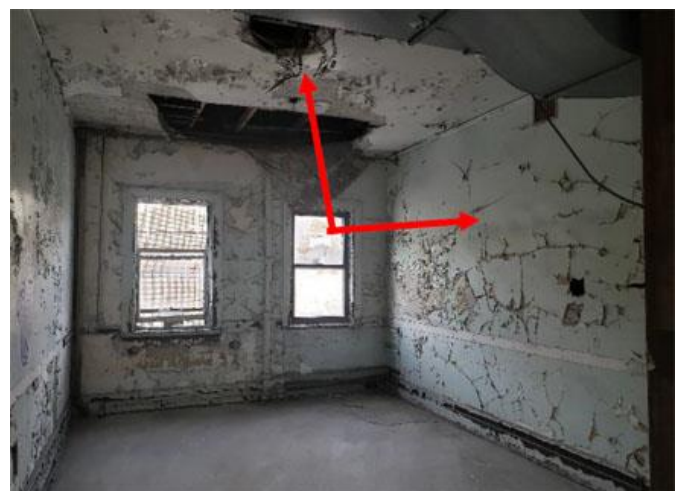
FIGURE 33 À l'étage, on retrouve une série de bureaux. Les murs et plafonds sont revêtus de plâtre. Source : STM.
