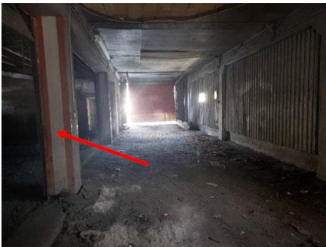
FIGURE 31. Autre vue intérieur du passage, cette fois vers l'arrière. Le mur de trouvant à droite était à l'origine ouvert sur l'extérieur. La flèche montre l'une des colonnes en béton de la structure de l'immeuble. Source : STM.
