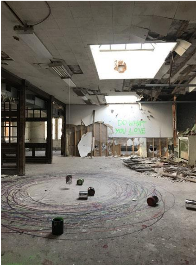
FIGURE 34 À l'étage, grande aire ouverte éclairée par des puits de lumière. À gauche, les vestiges des cloisons de bois vitrées qui séparaient des bureaux. Source : STM.
