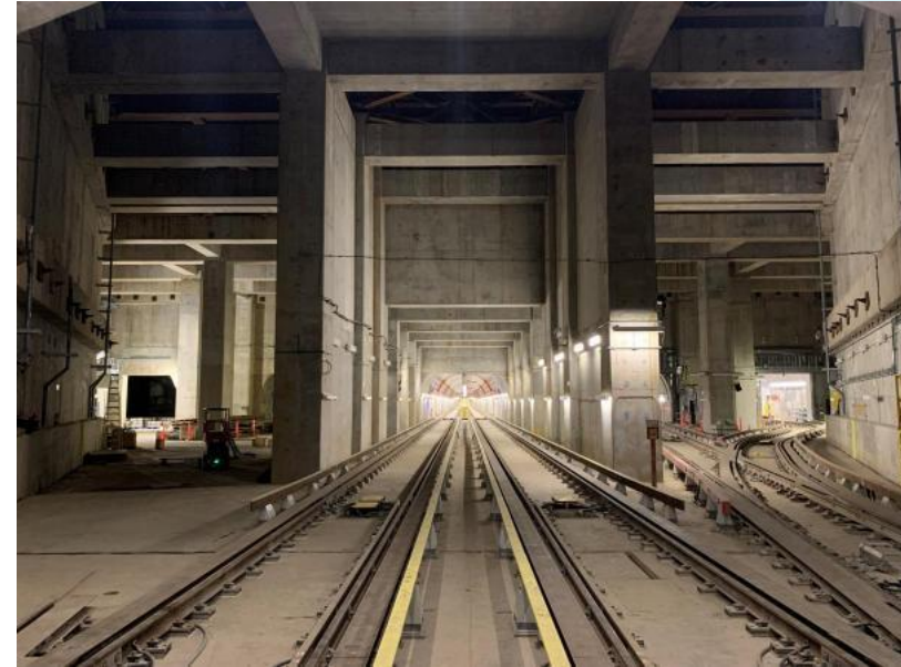
Faisceau du garage Côte-Vertu
