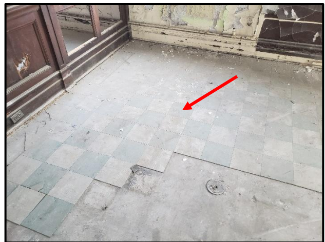
2 e étage | Groupe 03 Tuile de vinyle (et colle) 9" x 9" vert et blanc sur béton Présence d'amiante
